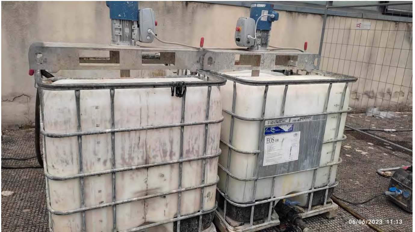
Area preparazione miscela
